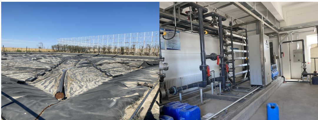
填埋场渗滤液收集池
