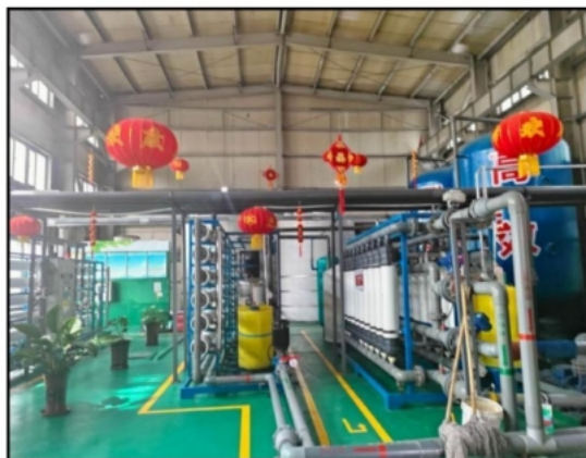
现有矿井水深度处理车间
