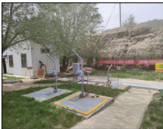
现有生活污水处理站
