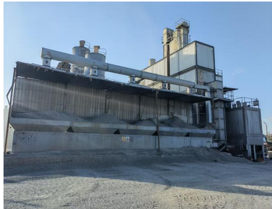
沥青混凝土进料口
