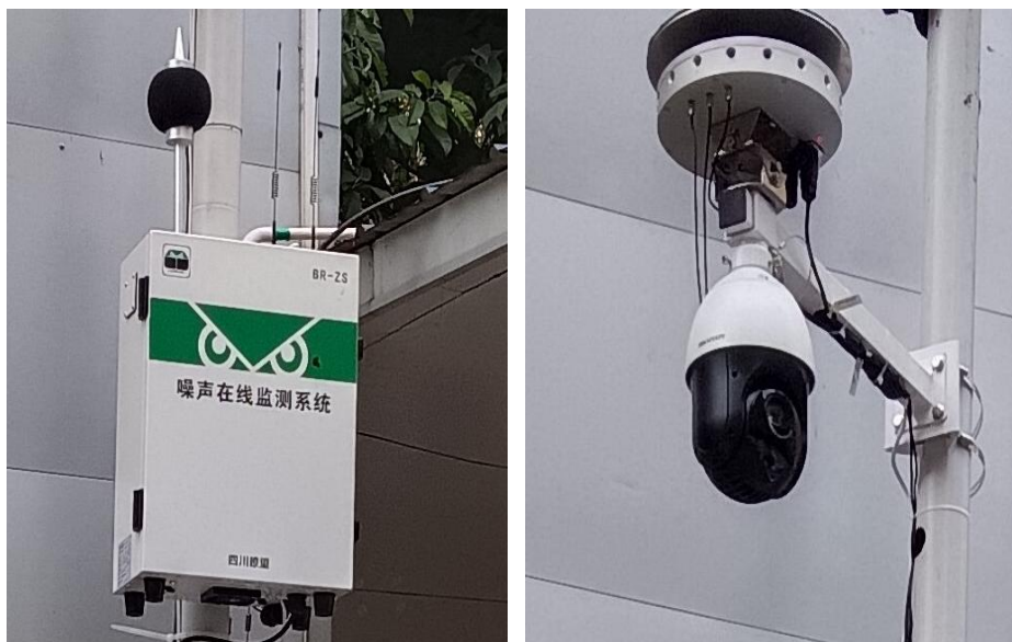
图 3-4 建筑施工噪声采集装置
