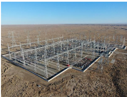
芨芨湖 750kV 变电站航拍图
