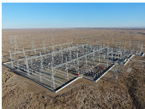
750kV 芨芨湖变电站
