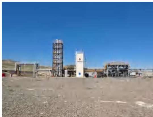
现有装置-日处理五万方 LNG 液化装置
