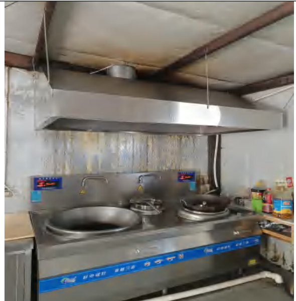
原有工程油烟净化设施
