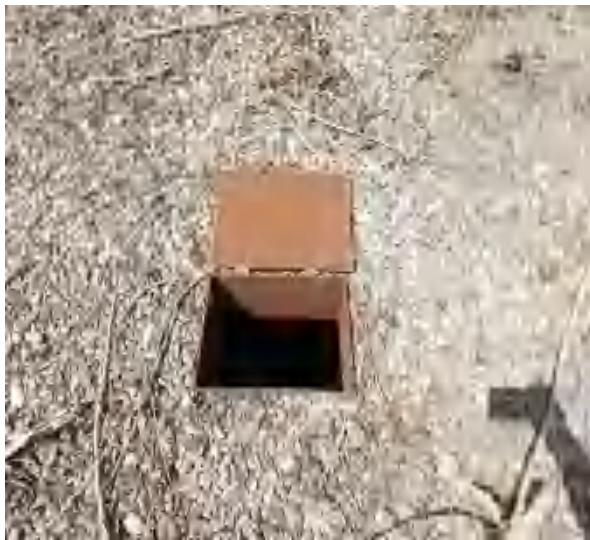
原有工程化粪池
