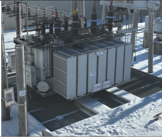
站内#1 主变（本期改造）
