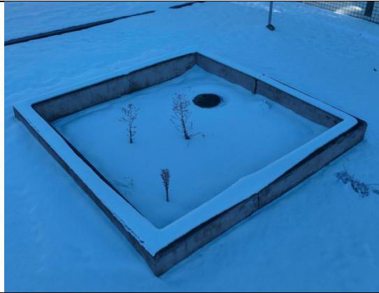
站内事故油池
