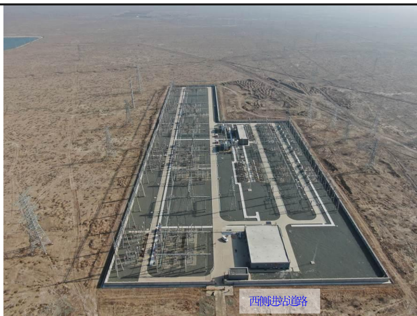
昌吉幸福 220kV 变电站俯视图
