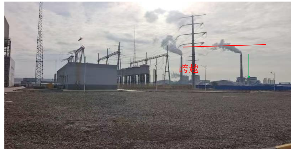
火电厂变电站
