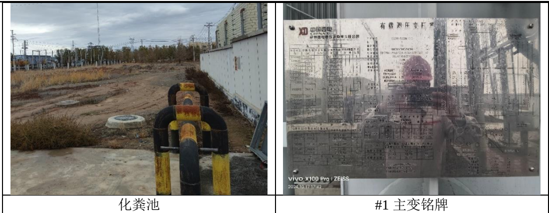
图 2 农业园 110kV 变电站站内设施现状图
