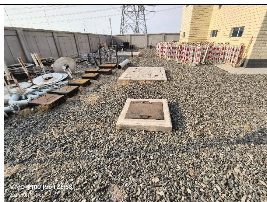
地埋式污水处理设施
