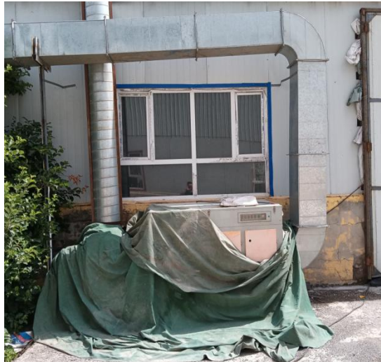
现有项目废气处理设施
