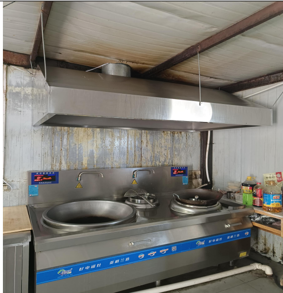
原有工程油烟净化设施
