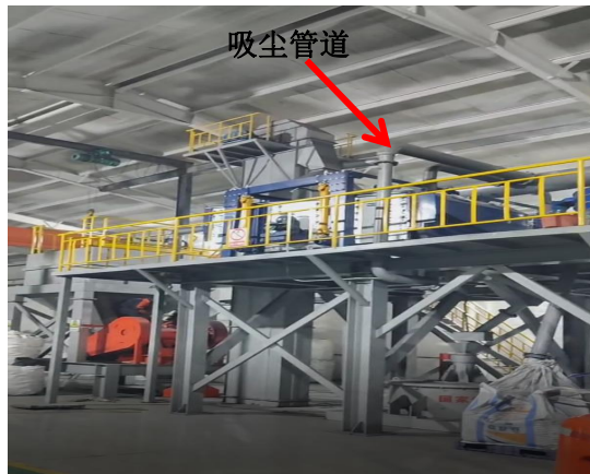
一期工程车间内生产设备
