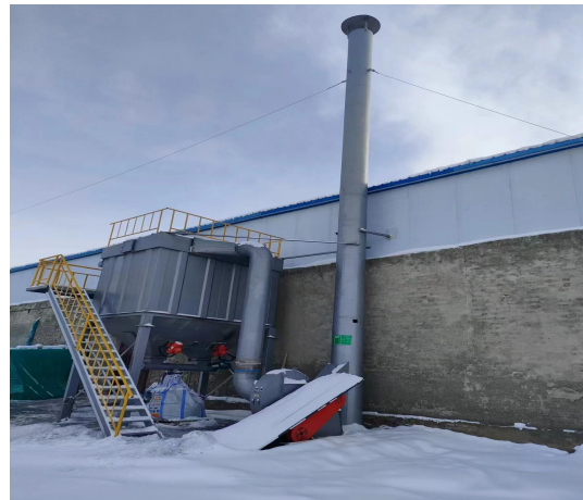
一期工程脉冲式除尘器 2#
