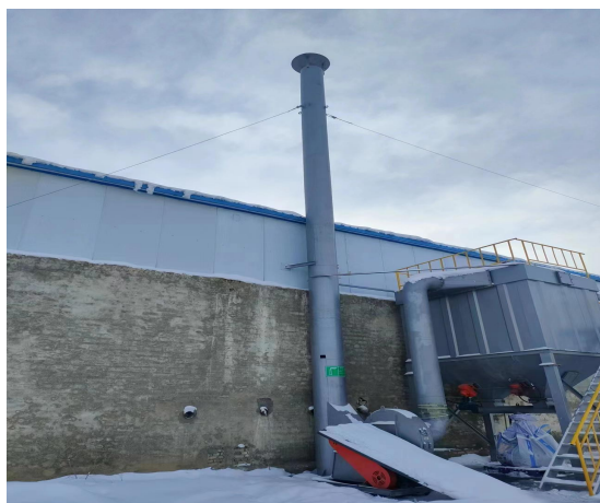
一期工程脉冲式除尘器 1#
