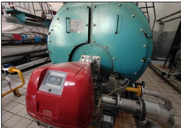
已建燃气锅炉 (2t/h)
