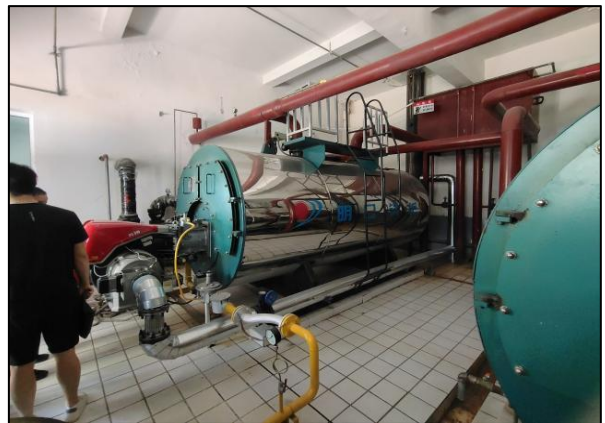
已建燃气锅炉 (3t/h)
