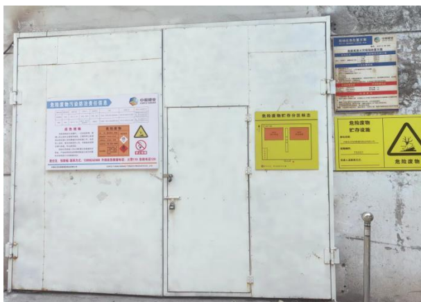
现有危险废物贮存设施
