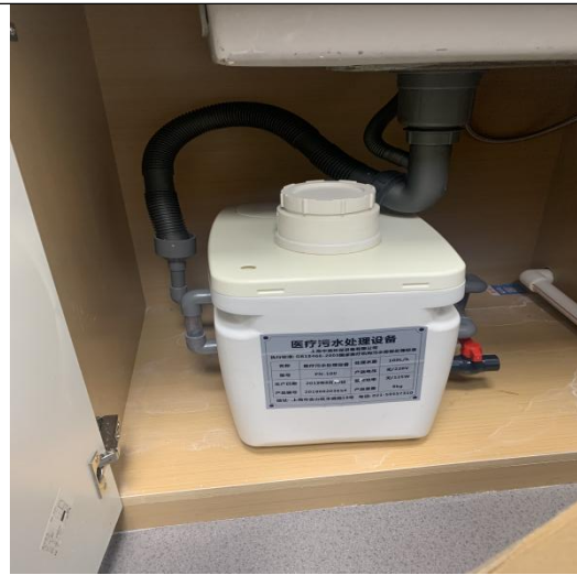
污水处理装置
