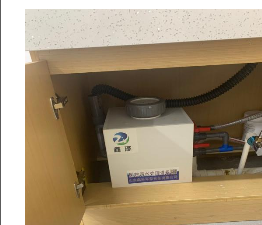
污水处理装置
