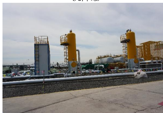
蒸汽混参装置
