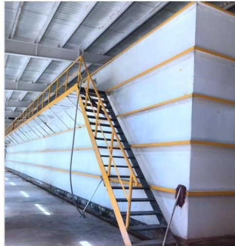
矿井水处理间
