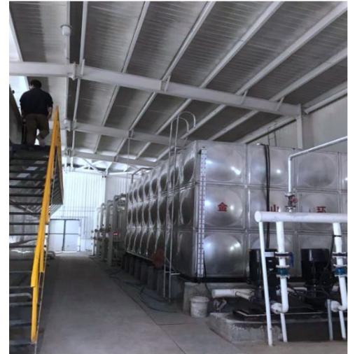
生活污水处理间
