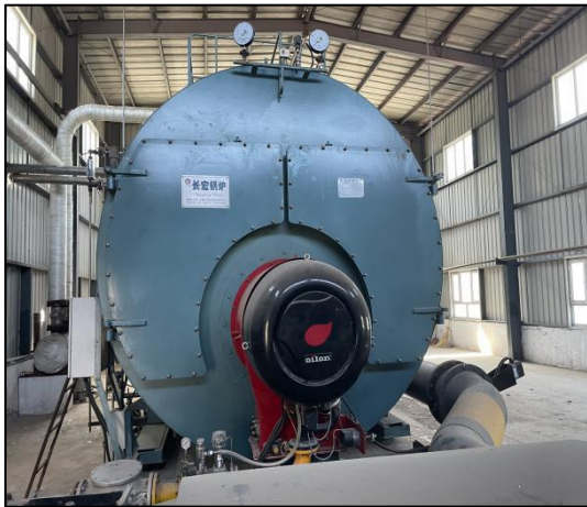
现有 15t/h 燃气蒸汽锅炉
