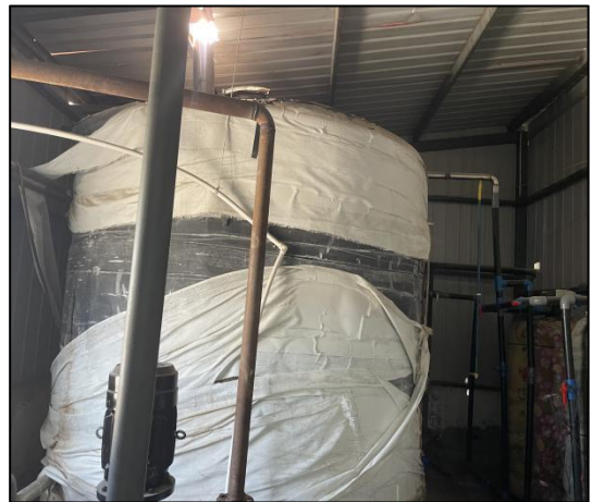
锅炉房现有净水系统现状
