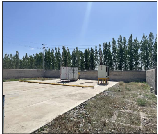
现有天然气减压撬现状
