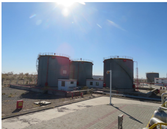
盆 5 天然气处理站储罐区
