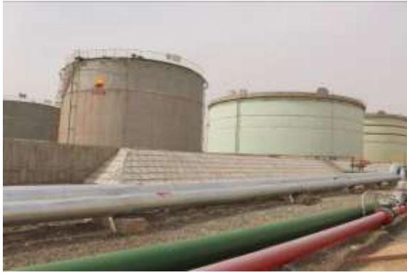
北三台泵站罐区
