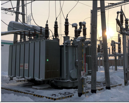
永丰变电站 1#主变
