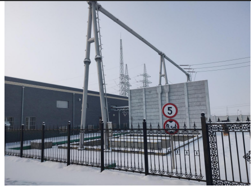
永丰变电站 2#主变扩建预留区域
