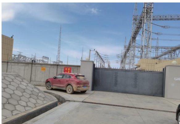
木垒 750kV 变电站
