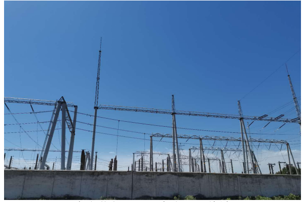
吉木萨尔 220kV 变电站出线端
