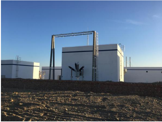
粤水电信友奇台北塔山风电项目 110kV 升压站
