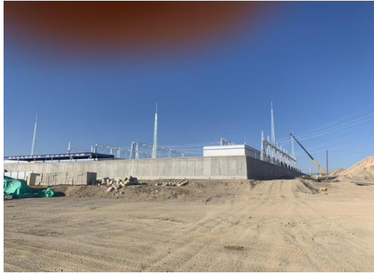
北塔山西 220kV 升压站
