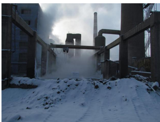
脱硫除尘设施
