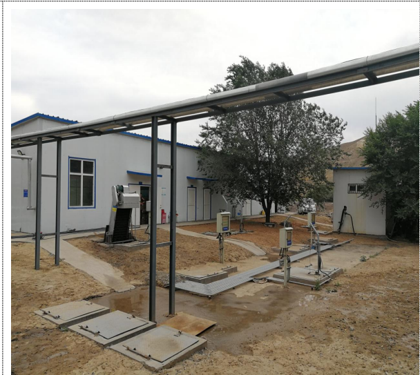
地埋式一体化污水处理设施
