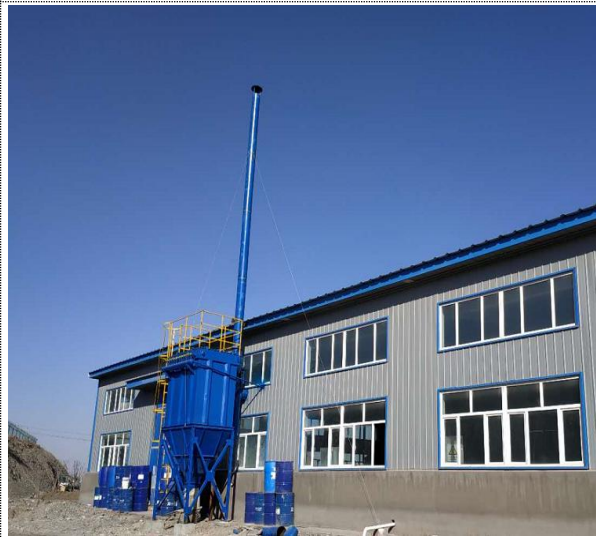
2#环保功能型涂料生产车间除尘器
