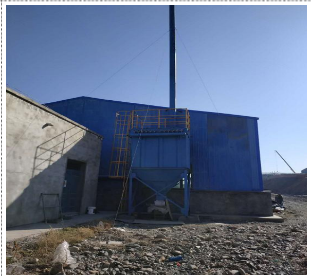
保温砂浆生产车间除尘器
