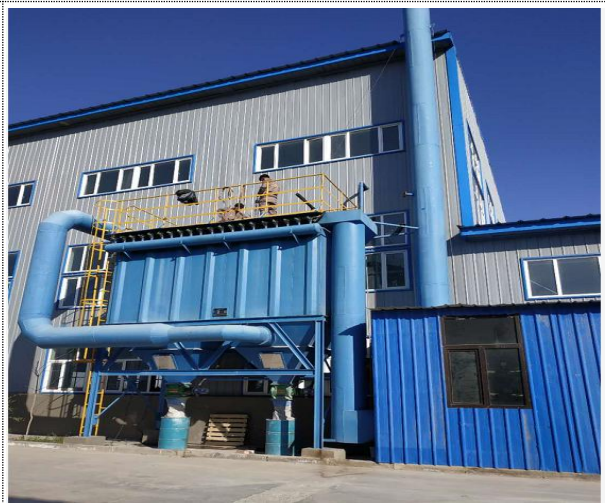
1#环保功能型涂料生产车间除尘器
