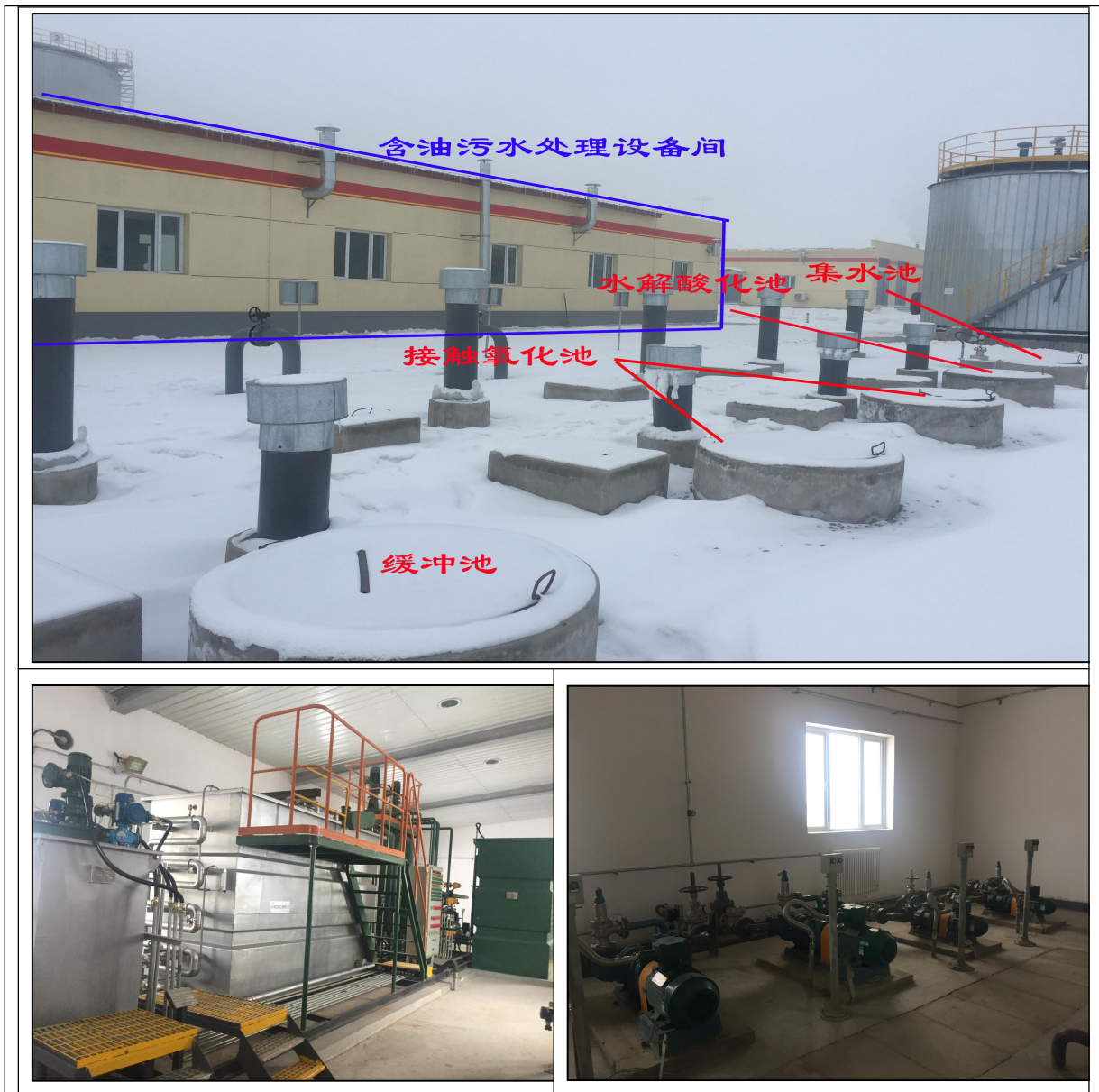
图6 含油污水处理设施
