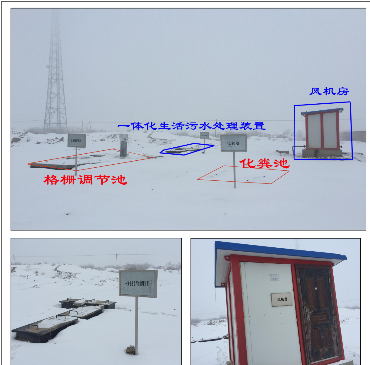
图5 生活污水处理设施
