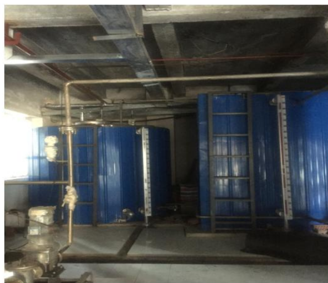
照片 2 尿素溶液储罐
