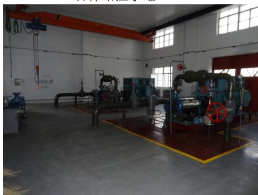
沙南站注水泵
