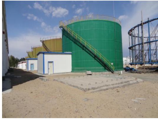
彩南站注水罐
