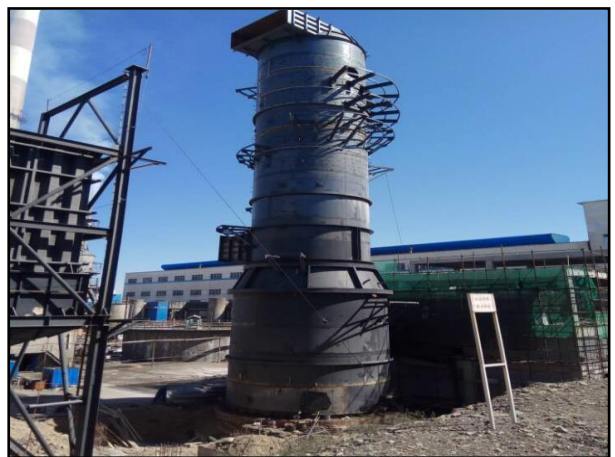
原有脱硫除尘装置
