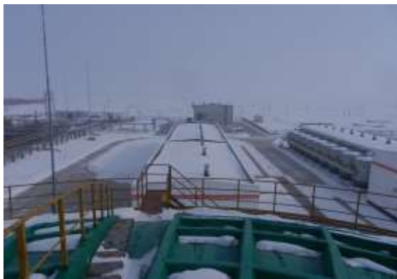
装置区压缩厂房
