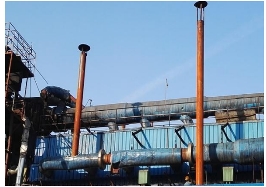
再处理滤袋排气筒
