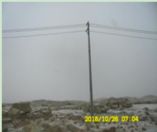
矿区已架设好的矿区输电线路
