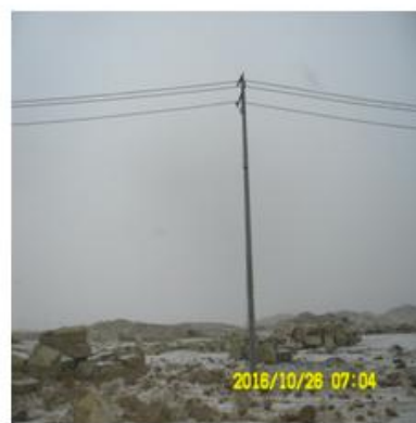
矿区已架输电线路
